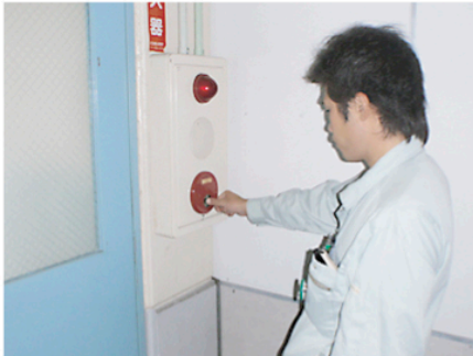
こちらは屋内の自動火災報知機の点検風景。万一の火災の際に作動しない!! なんてことが絶対ないよう、確実に点検していきます。
